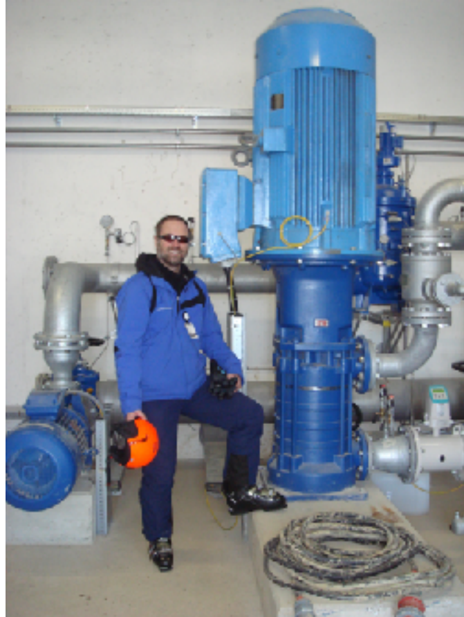
Arno Schweiger in der Pumpstation Hochhäderich
